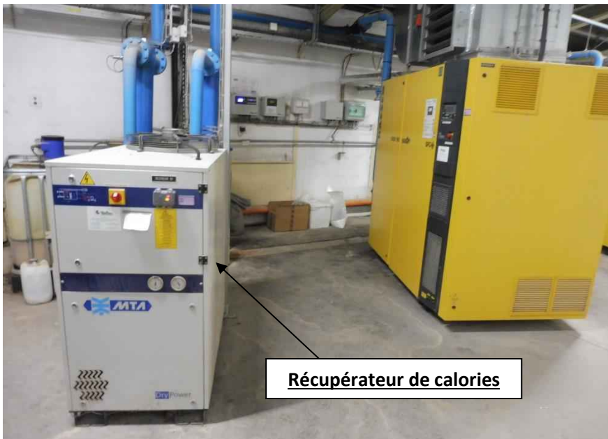
Local des compresseurs d'air
