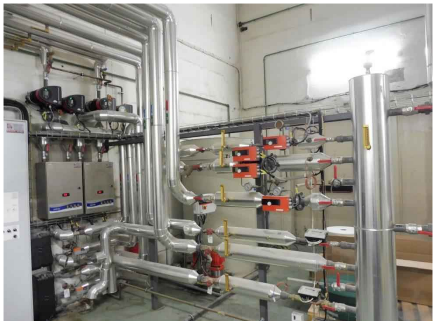
Dispositif de récupération des calories – Echangeurs de chaleur
